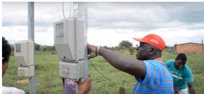
Figura 6 - Chegada da energia na comunidade
